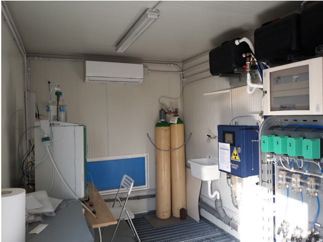
Figura 2. Esempio di una installazione sul campo in container di sensori per la analisi di Disinfection By Products (DBP) in acque potabilizzate
